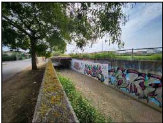
Vista de la zona canalitzada a l'aire lliure
