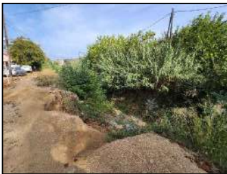
Vista del talús erosionat
