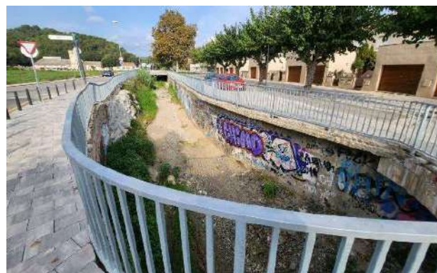
Foto 5. Tram amb murs de formigó armat. Es pot veure com els murs estan afectats pel vandalisme i el deficient manteniment de la llera. Algunes canyes s'observen.
