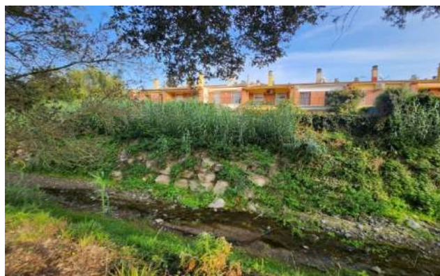
Foto 2. Vista del marge esquerre de la llera on es pot veure com els murs d'escullera i les cases delimiten la llera. Es constata també que el fons de llera és natural.
