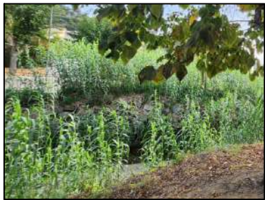
Vista de l'escullera amb presència de vegetació seca i canyissar a la coronació
